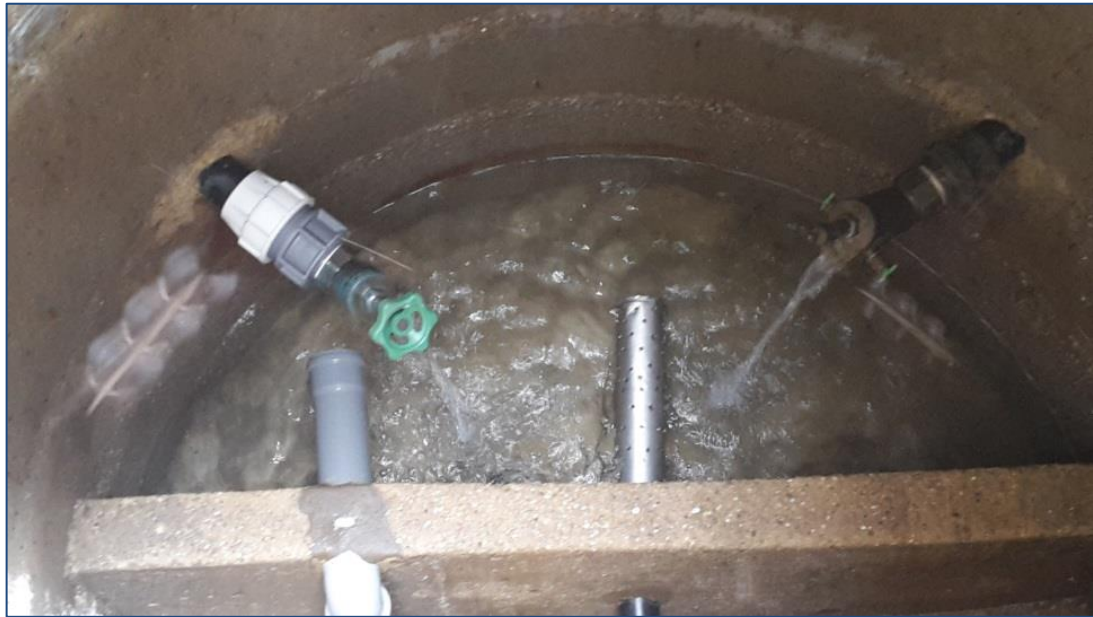
Abbildung 2: Sammelschacht Q1 und Q2
